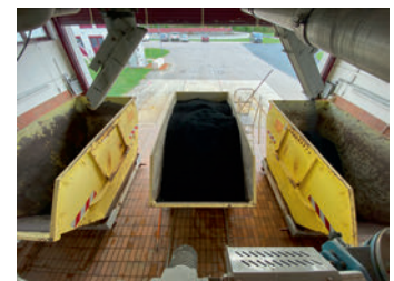
Bild 5: ...zum Containerraum der Schlammpresse (Bilder: WAD GmbH)
