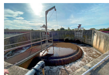
Zuführung von Eisen-III-Chlorid im Verteilerbauwerk Nachklärbecken
