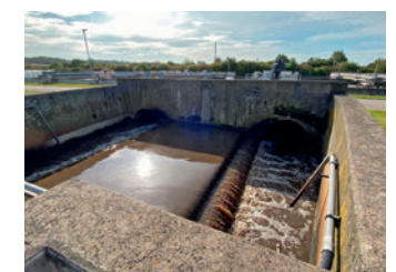
Zuführung von Natriumaluminat Verteilerbauwerk Belebungsbecken
