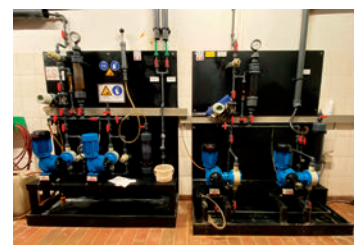
Dosieranlage für Natriumaluminat und Eisen-III-Chlorid mit Dosierpumpen
